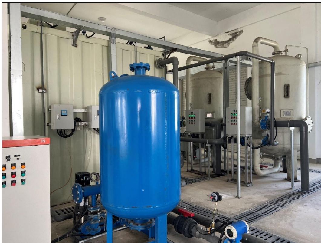
图 4.5-1 车辆段污水处理设备
