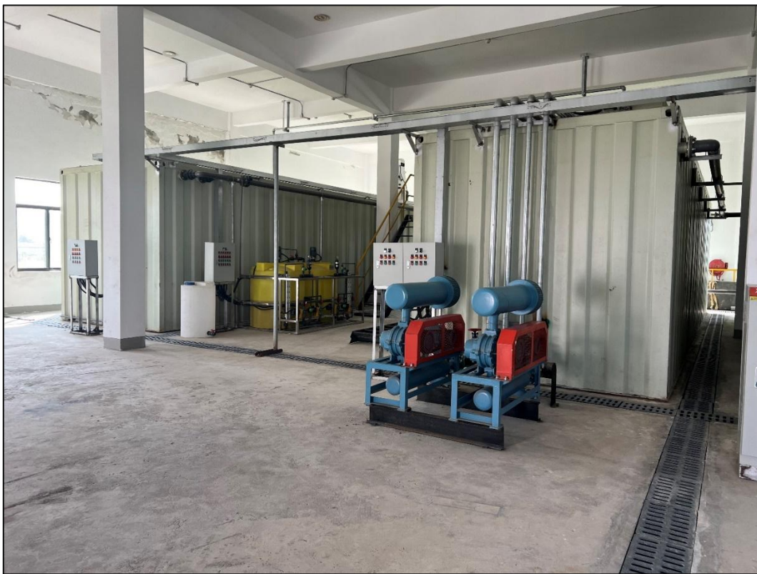
图 4.5-2 车辆段污水处理设备
