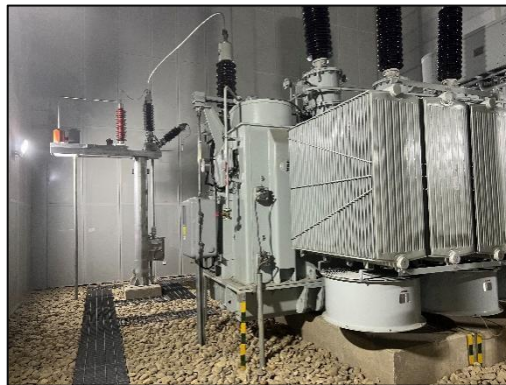
图 8-4 政务中心主变电所变压器
