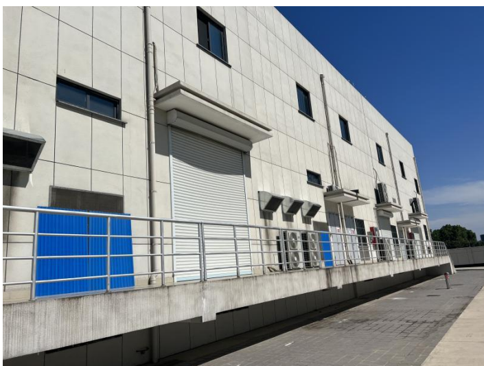
图 8-4 主变电所吸音墙
